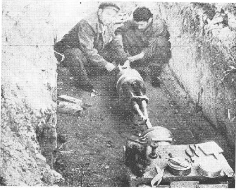
Enerji kablosunda ek
